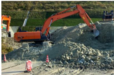
安全通路・立入禁止区域
